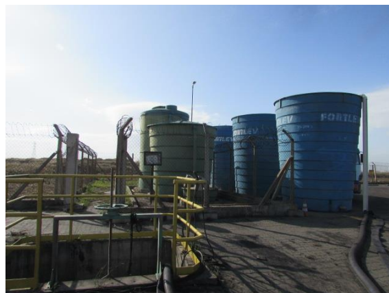
Figura 14: ETE do cais.
