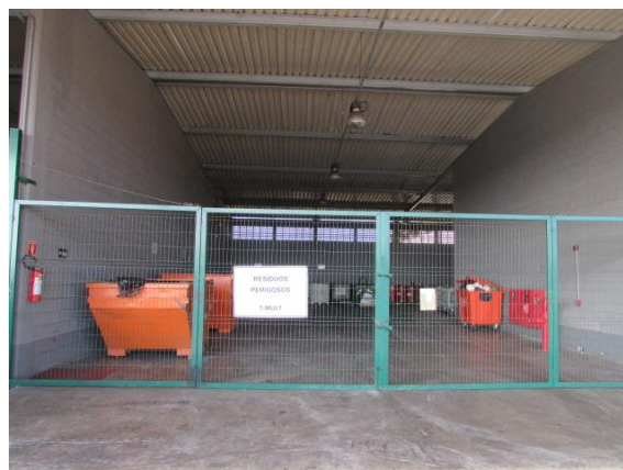
Figura 30: Baia de resíduos perigosos no Galpão de Resíduos.
