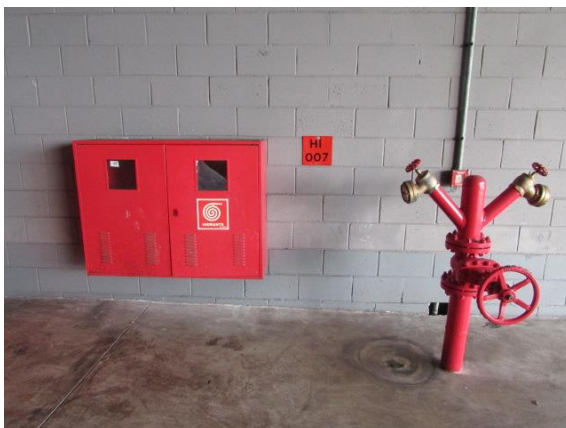
Figura 25: Hidrantes de incêndio no Galpão de Resíduos.
