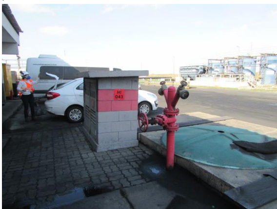
Figura 5: Estrutura de combate a incêndio próximo a ETEI.
