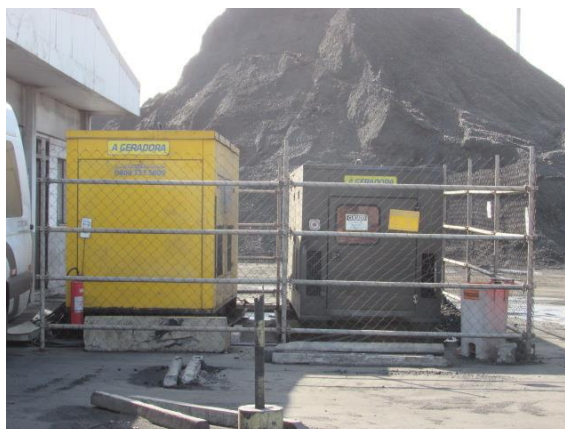
Figura 6: Geradores isolados e com bacias de contenção próximos a ETEI.
