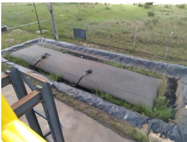
Figura 5.6 – Bag para estocagem do lodo da ETEI
