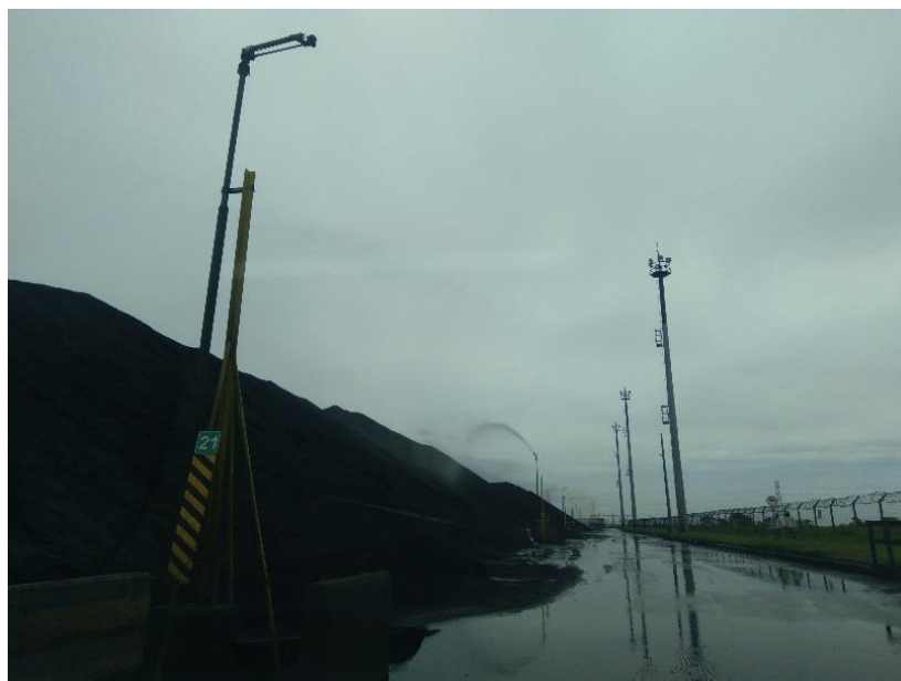
Figura 5.10 – Funcionamento do sistema de aspersão do pátio de estocagem de granéis sólidos
