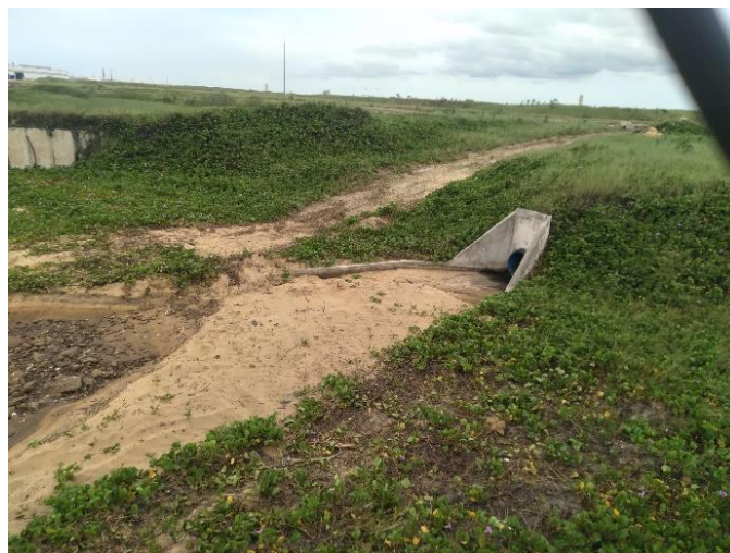
Figura 5.7 – Emissário de lançamento dos efluentes tratados no Canal de Navegação do T2
