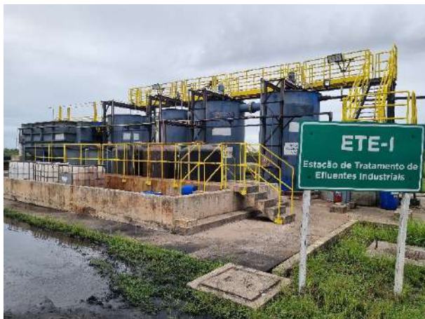
Figura 4-4 – Estação de Tratamento de Efluentes Industriais - ETEI
