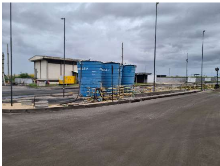
Figura 4-6 – Tanques de armazenamento dos efluentes provenientes das operações com fertilizantes
