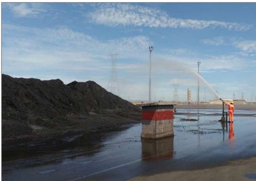
Figura 6 – Sistema de Aspersão de Pilhas do Pátio de Estocagem de Granéis Sólidos
